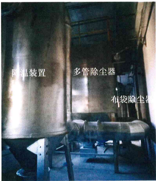
十二生肖祭祀园尾气净化处理系统
