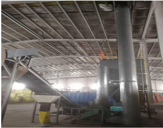
8#掺混车间蛋白控释肥进料粉尘布袋除尘器及排气筒
