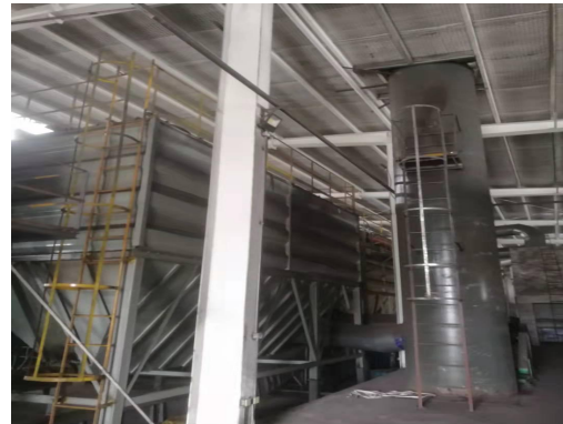
7#造粒车间二级冷却、三级筛分布袋除尘器及排气筒
