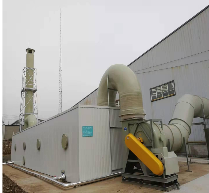
2#发酵车间生物喷淋洗涤及排气筒
