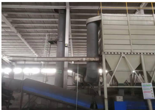
7#造粒车间原料储存、进料口收尘、粉碎布袋除尘器及排气筒
