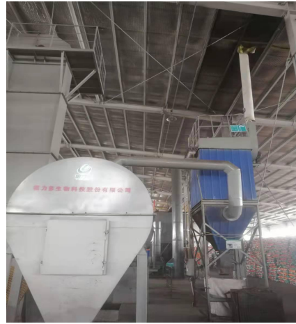
8#掺混车间生物蛋白控释肥混合粉尘布袋除尘器及排气筒
