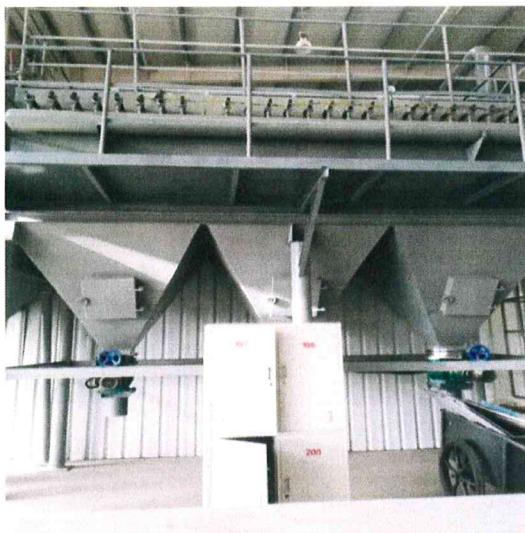
岩棉生产车间配置的脉冲收尘器
