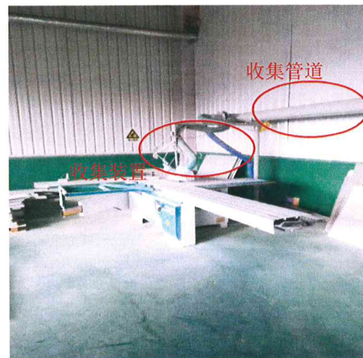
硅酸钙板车间内集气装置及管道
