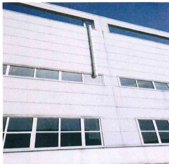
与硅酸钙板收尘装置共用的 15m 排气筒
