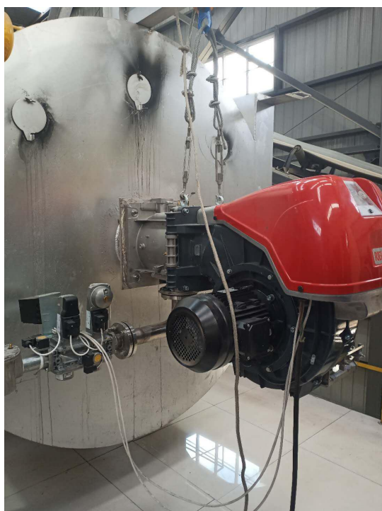
烘干机天然气低氮燃烧器
