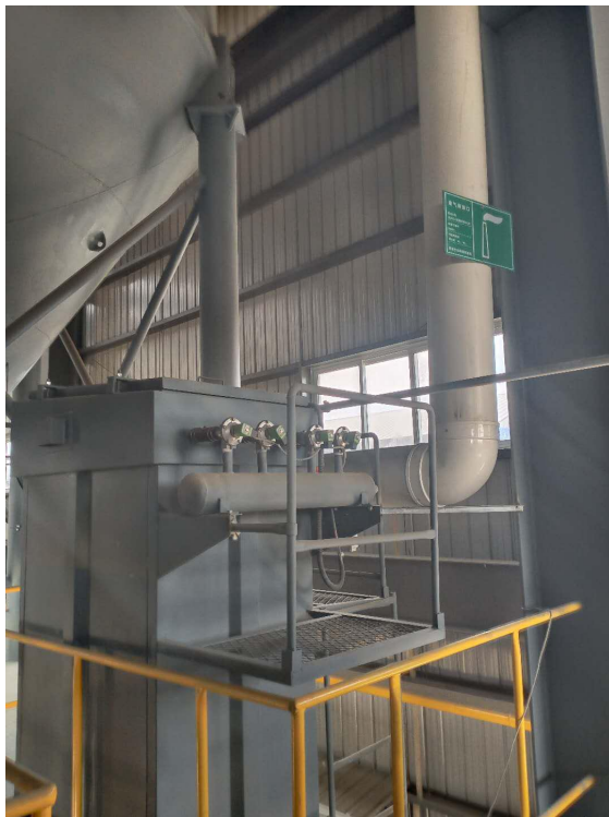
搅拌配置布袋除尘器+包装、搅拌共用 15m 排气筒
