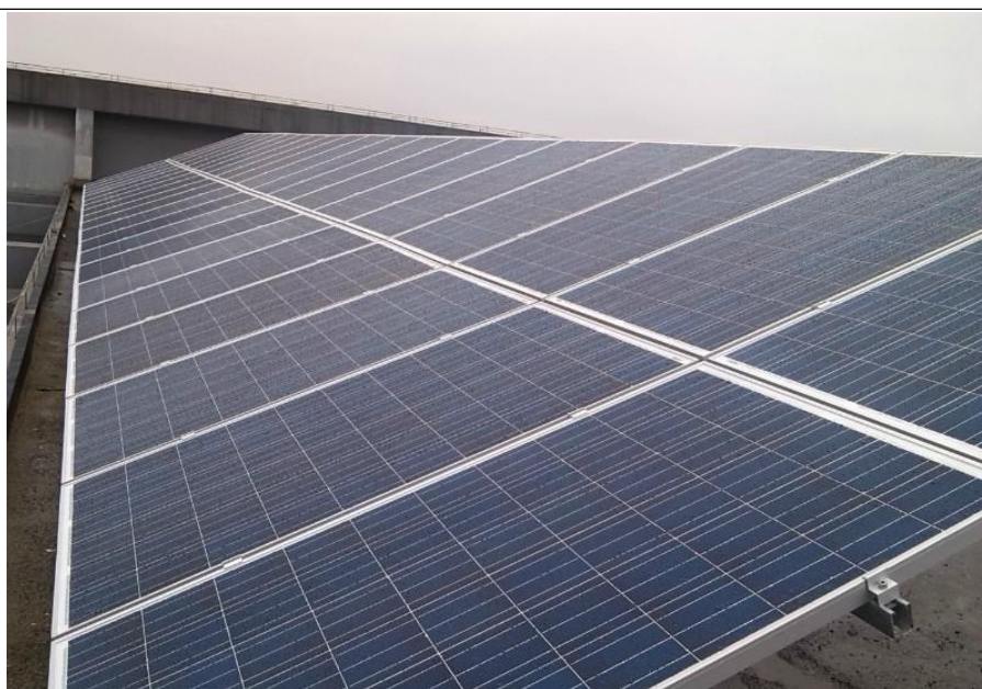
图 4-3 太阳能屋顶光伏
