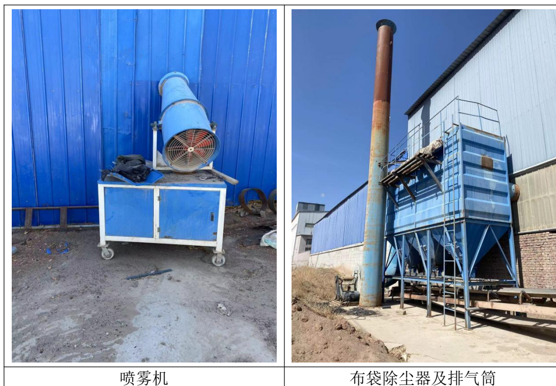
图 4-1 废气治理设施实景图
