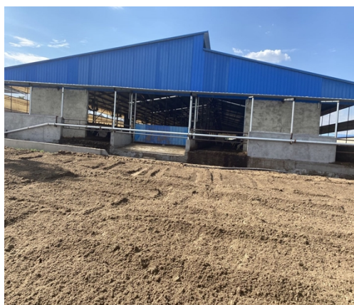
粪便收集边沟
