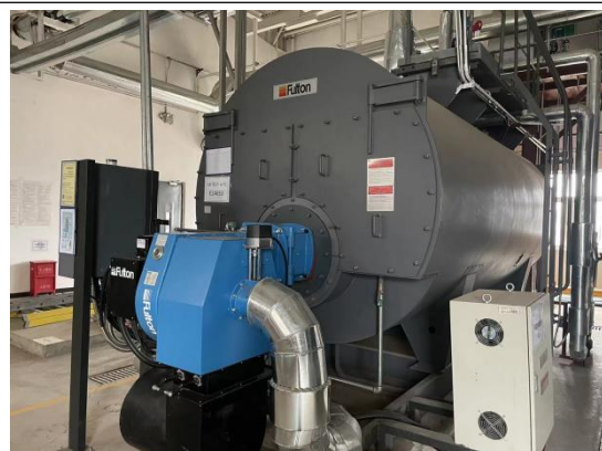
低氮燃烧锅炉---1#4t
