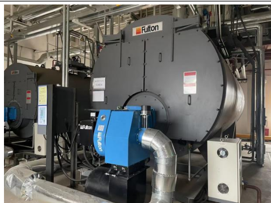
低氮燃烧锅炉---2#6t
