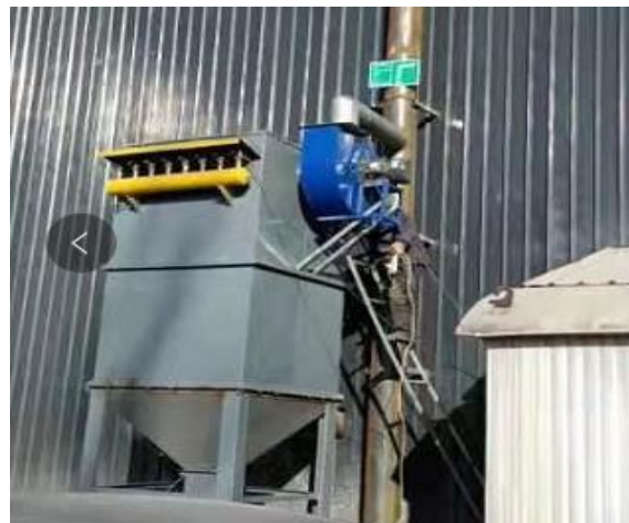
图 4-4 上料、搅拌工序布袋除尘器及排气筒
