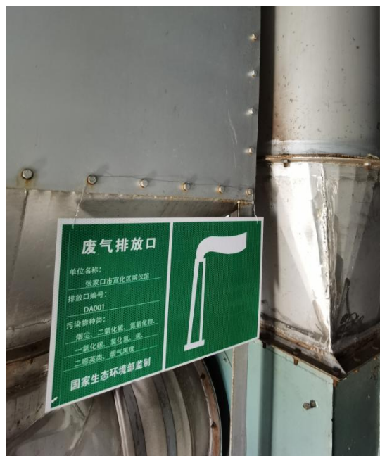
火化机废气排放口 DA001
