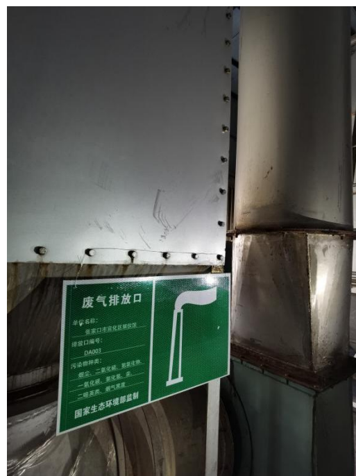
火化机废气排放口 DA003
