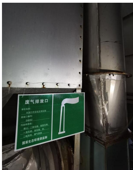
火化机废气排放口 DA002
