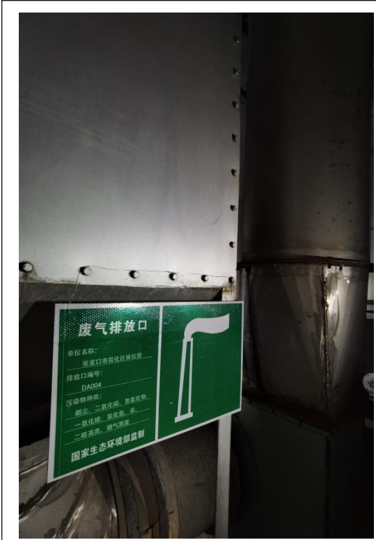
火化机废气排放口 DA004
