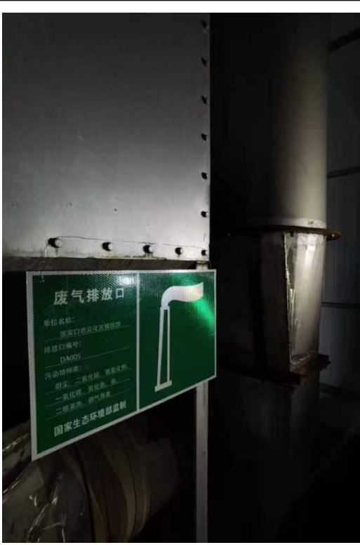
火化机废气排放口 DA005
