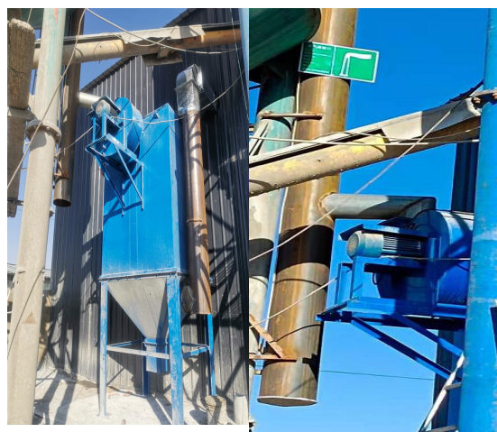
图 4-4 上料、搅拌工序布袋除尘器及排气筒
