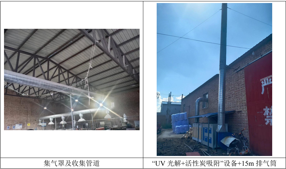
图 4-1 废气治理设施
