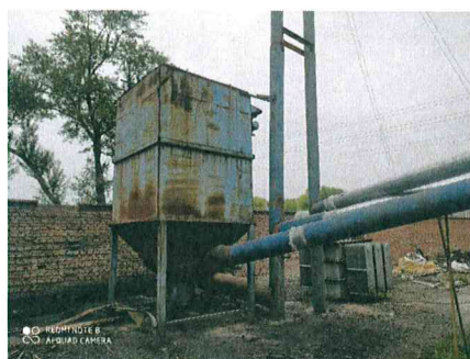
电炉区布袋除尘器
