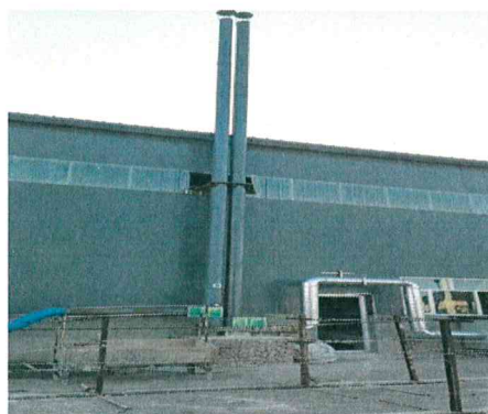
造型区及抛丸机的排气筒
