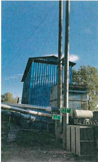
砂处理和电炉区排气筒
