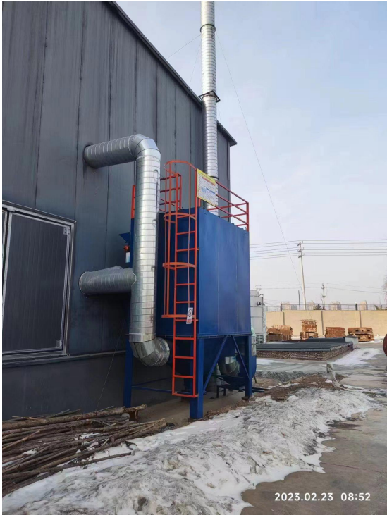
布袋除尘器+15m 排气筒
